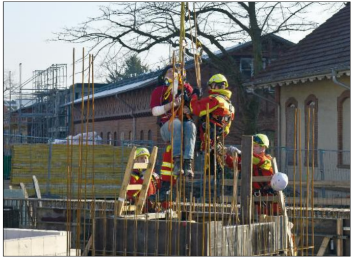
09.03.2016, THY, LANGENHORN: Arbeitsunfall im Neubaugebiet, ein Arbeiter stürzt in einen etwa vier Meter tiefen Fahrstuhl-schacht. Medizinische Versorgung durch die Rettungsdienstkkräfte, danach Rettung des Patienten durch die SEGh mithilfe eines Baukrans
