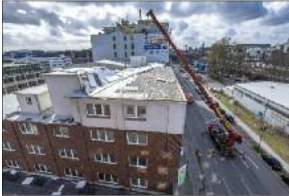
01.04.2015, DRZF, HARVESTEHUDE: 300 qm Flachdach droht auf Straße zu stürzen. Dachhaut von Höhenrettern mittels Kran und Sandsäcken gesichert. Keine verletzten Personen
