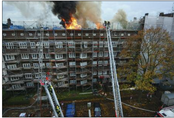
04.11.2014, FEU5, EIMSBÜTTEL: Feuer auf Dach eines fünfgeschossigen Mehrfamilienhauses, vermutlich infolge von Dachdeckerarbeiten. Großaufgebot durch Auslösung der 5. Alarmfolge. Bewohner im Hotel untergebracht, ein leicht verletzter Arbeiter
