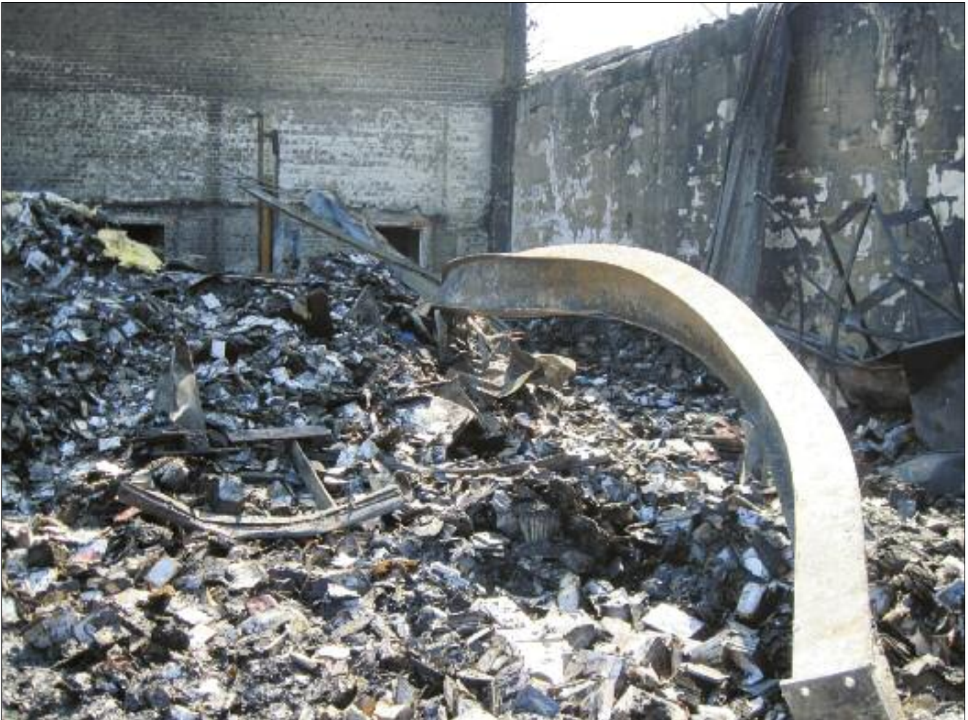
Großbrand am Albert-Schweitzer-Ring: Nach 48-stündiger massiver Brandbekämpfung wurden zwei betroffene Lagerhallen vollständig zerstört. Zwei angrenzende
