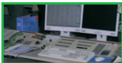
Zwei Leitstellen – ein System:
